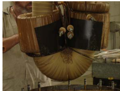
Retirada da parte ativa para análise
